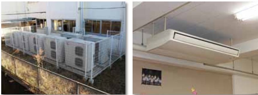
市内中学校に設置されたエアコン室外機・室内機（電気）
